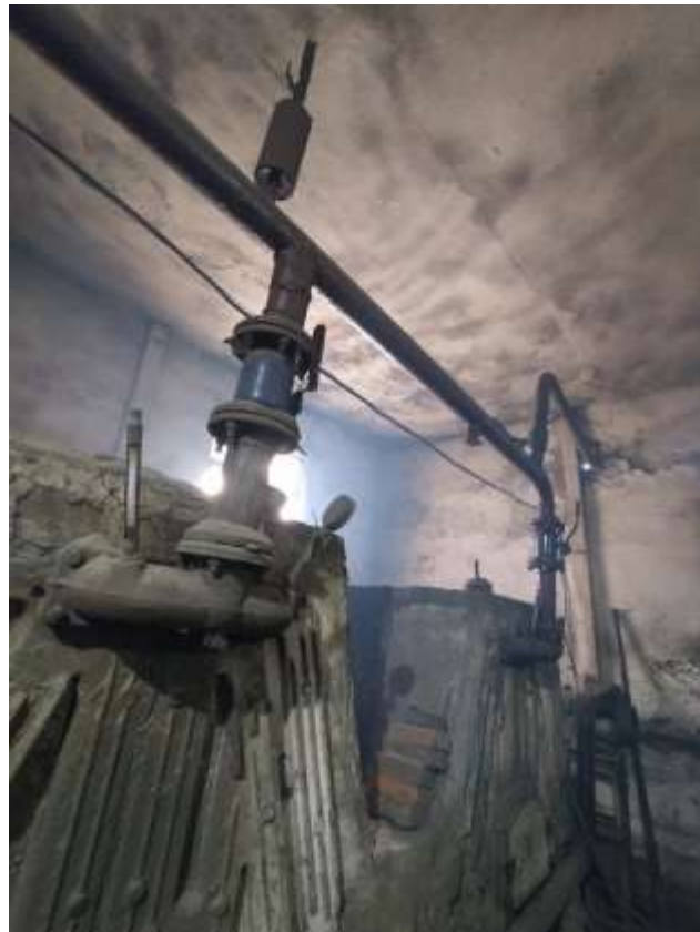
Состояние отопительных котлов
