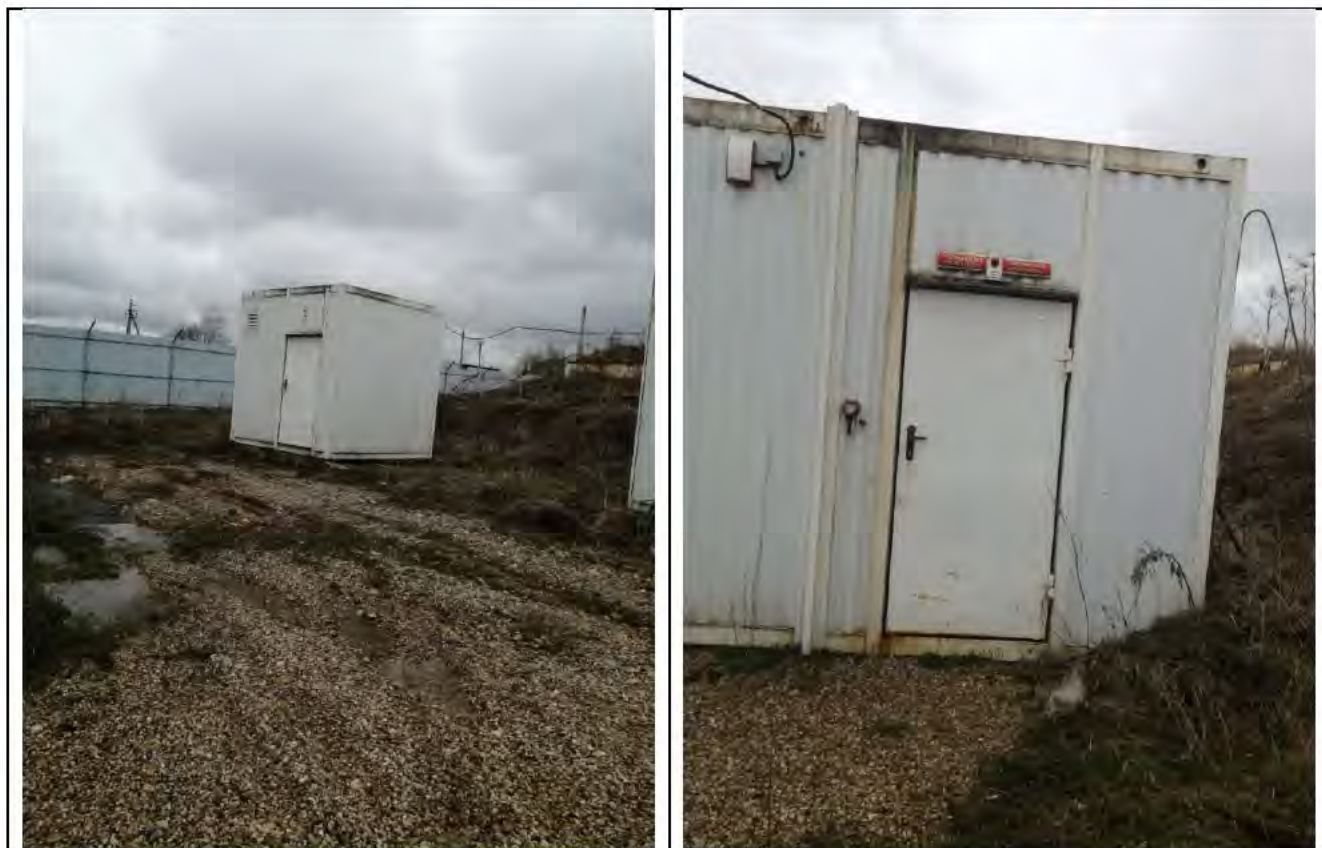
Наименование имущества: Блочно-модульная котельная установленной теплопроизводительностью 17,9МВт
